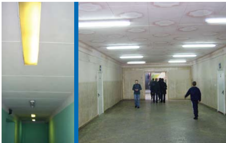
Система освещения до и после замены
