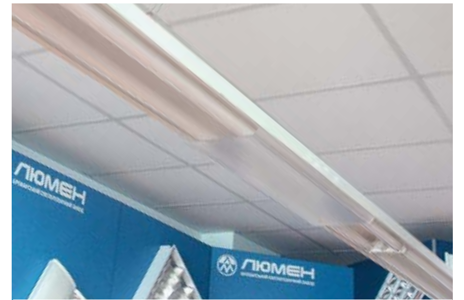
МАГИСТРАЛЬНАЯ СИСТЕМА ОСВЕЩЕНИЯ ПРОИЗВОДСТВА БСЗ «ЛЮМЕН»
